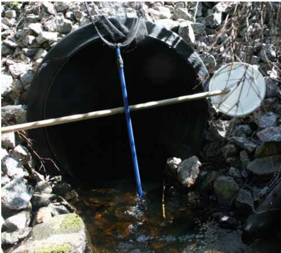
Figur 3:4. Vägtrumma strax nedströms våtmarken vid Gölarna. Trots att trumman är rejält tilltagen kan den utgöra ett partiellt vandringshinder under vårar med höga flöden i bäcken. Foto: Per Stolpe
